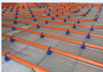
Exemple de chauffage par le sol
